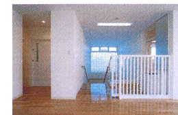
階段から転落しない防し柵
