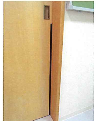
◎引き戸の安全ゴムの設置
